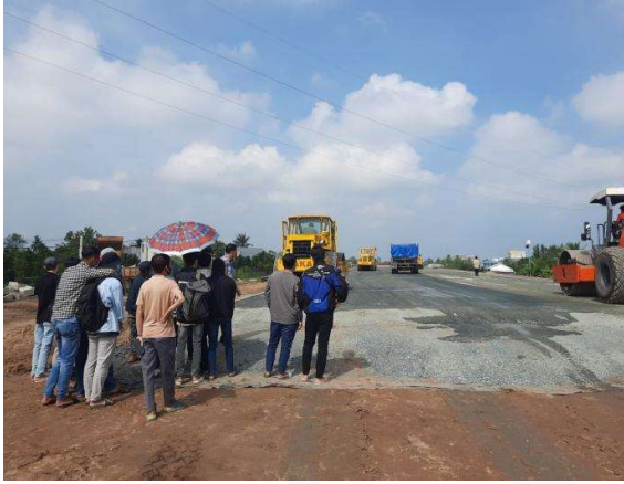
a) SV MTU xem công tác lu lên mặt đường cấp phối đá dăm
