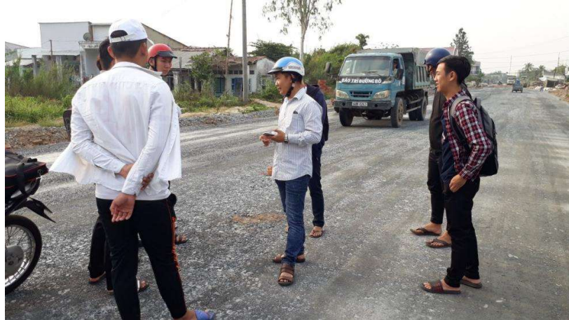
Hình 1. Sinh viên Khóa 15 xem thực tế công tác thi công nền cấp phối đá dăm tại công trình đường nối Quốc lộ 53 đến đường Võ Văn Kiệt, Phường 3, TP Vĩnh Long (2018)
